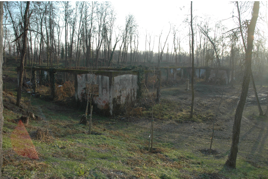
vista da nord-est del manufatto esistente pericolante
